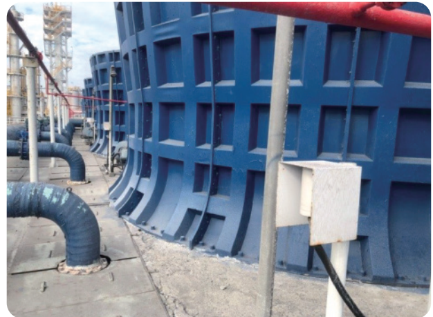
冷卻水塔旁空氣監測器
