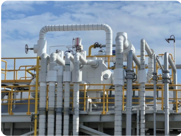
洲際碼頭區設置直燃式焚化爐
